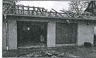
L'incendie a ravagé le toit du hangar. Photo DNA/Marie GERHARDY
